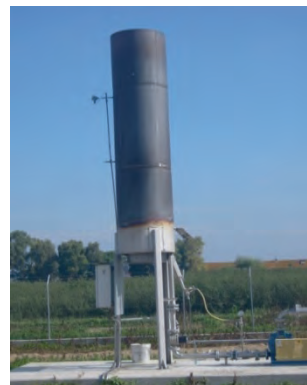
Figura 38: Torcia di emergenza (Fonte: Inail)
