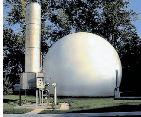
Figura 36: Pallone gasometrico (Fonte: Inail)
